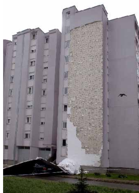
U Vukovaru pala fasada sa zgrade
